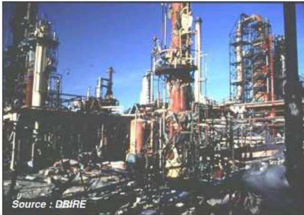
Figure 8 - Installations détruites par l'explosion
